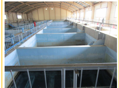
No. 1 急速ろか池
