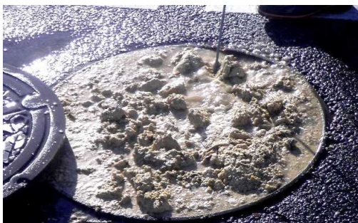
越流した油脂で下水道本管が閉塞し、下水が溢れたマンホール
