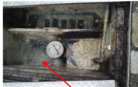
ばっ気している例 ばっ気による攪拌により、油脂が乳化し下流へ越流している。
