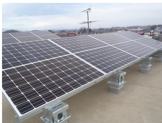
公共施設に設置した太陽光発電システム
