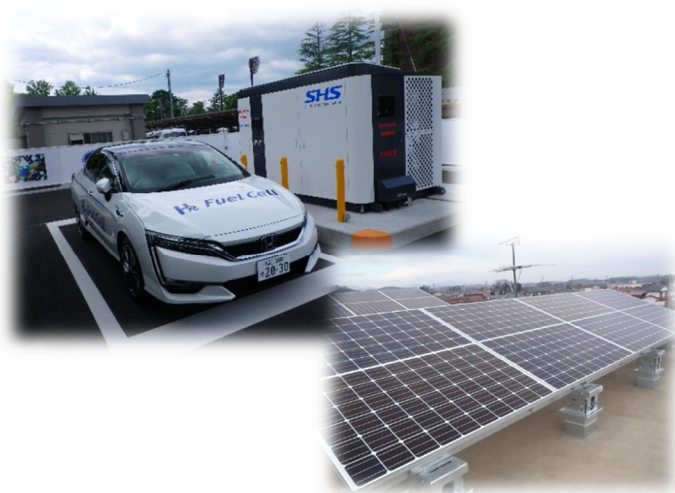
郡山市本庁舎に設置された水素ステーション・燃料電池自動車と太陽光発電設備
