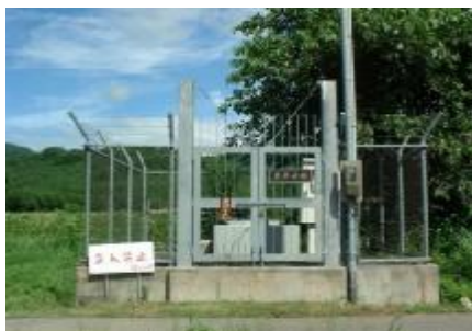
①取水施設(第2水源地)
