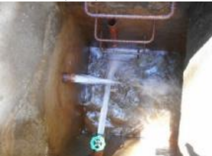
②減圧槽(内部)
