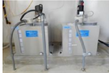
②配水池建物内部(滅菌機)
