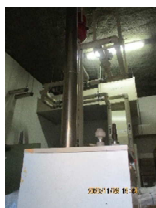
不要な配管や設備が残る
