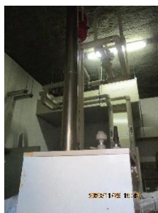
不要な配管や設備が残る
