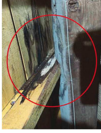
老朽化等による屋根材の腐朽
