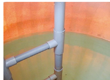
塗装が劣化し槽内に光が透過している
