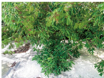
貯水槽上部が木の枝で覆われている
