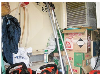
貯水槽周辺が物置化している
