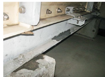
貯水槽底部から漏水している
