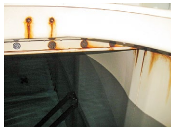
槽内のボルトが錆びついている
