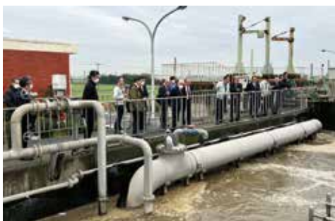
佐賀市下水浄化センター
