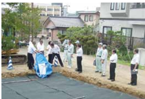
除染作業で発生した土壌などの埋設作業を視察する議員
