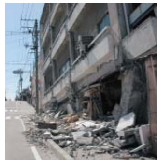
震災で損壊した店舗兼住宅
