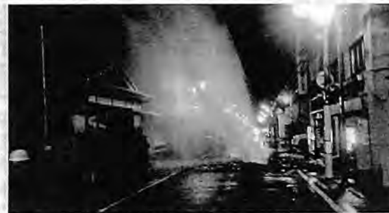
水道管本管の破裂は土砂も巻き上げ非常に危険
