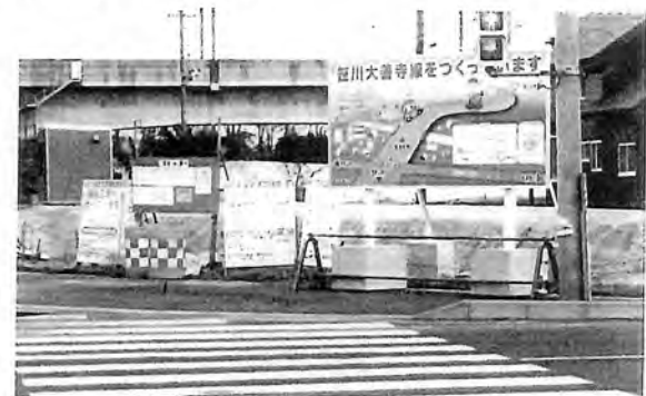
平成31年3月開通を目指し急ピッチで建設工事が進められる笹川大善寺線
