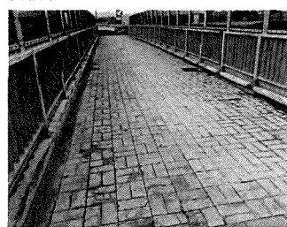
劣化が激しいご線橋
