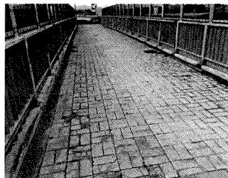
劣化が激しいご線橋
