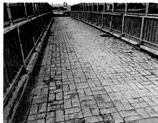
劣化が激しいご線橋
