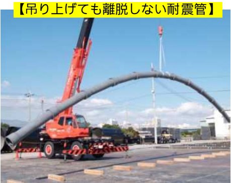
耐震管の採用
