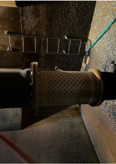
既設 流量調整弁 1982 (S57) 年設置 (42年経過)
