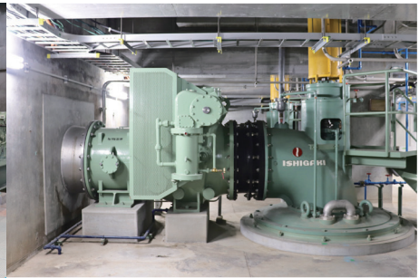
②ポンプ棟 地下1階(雨水ポンプ)
