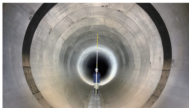
小原田貯留管
