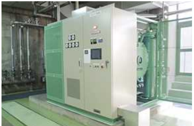
オゾン発生装置
