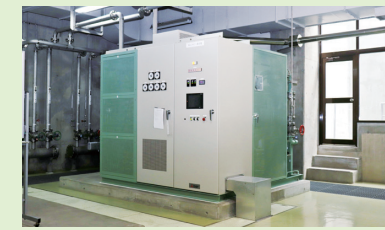
オゾン発生装置
