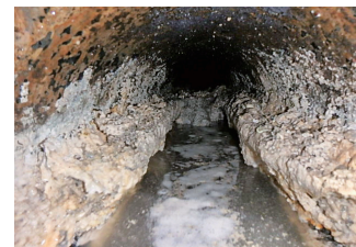
油により閉そくした下水道管
