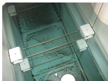
槽内底部に堆積物がある
