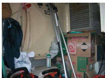
貯水槽周辺が物置化している
