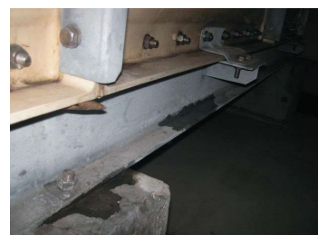
貯水槽底部から漏水している
