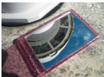
通気管の防虫網が破損している
