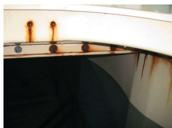
槽内のボルトが錆びついている
