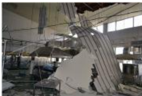
●東日本大震災による被害 （中学校給食センター）
